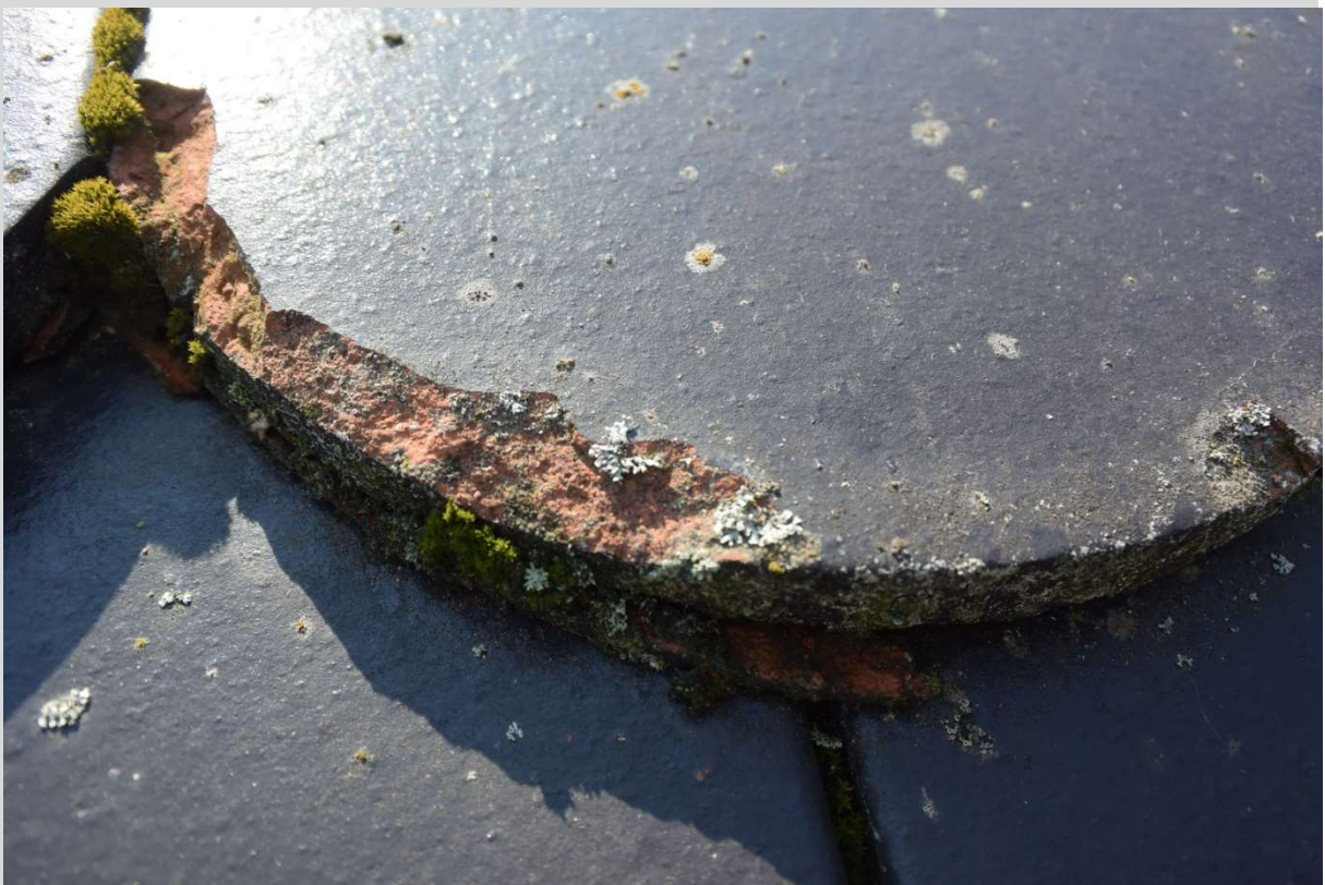
Abbildung 7: Abspregung an engobierten Biberschwanz-Ziegelkanten, Flechtenwachstum
