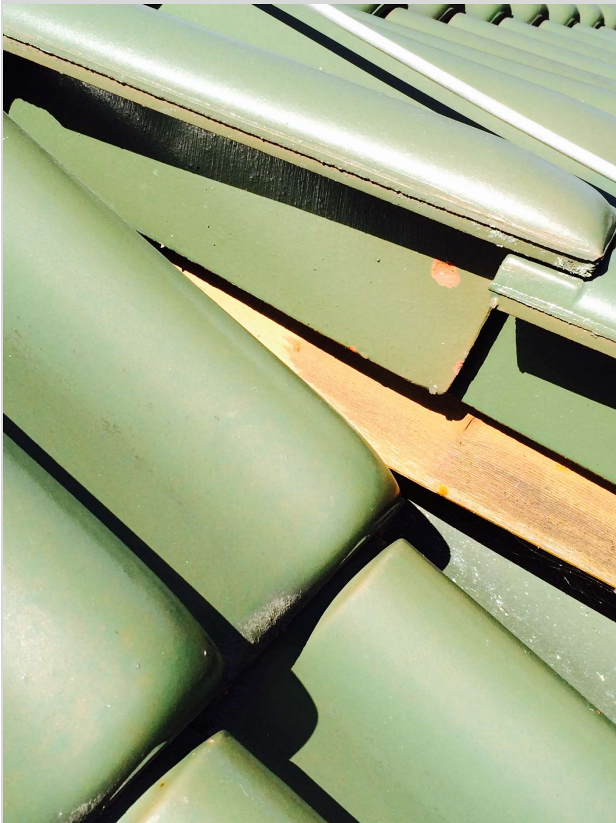
Abbildung 4: Kraterförmige Abplatzungen an einem Ortgangziegel
