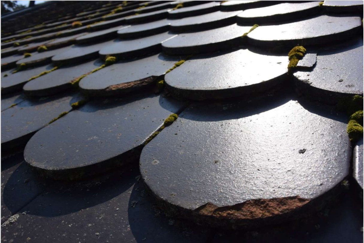
Abbildung 5: Abspregung an engobierten Biberschwanz-Ziegelkanten
