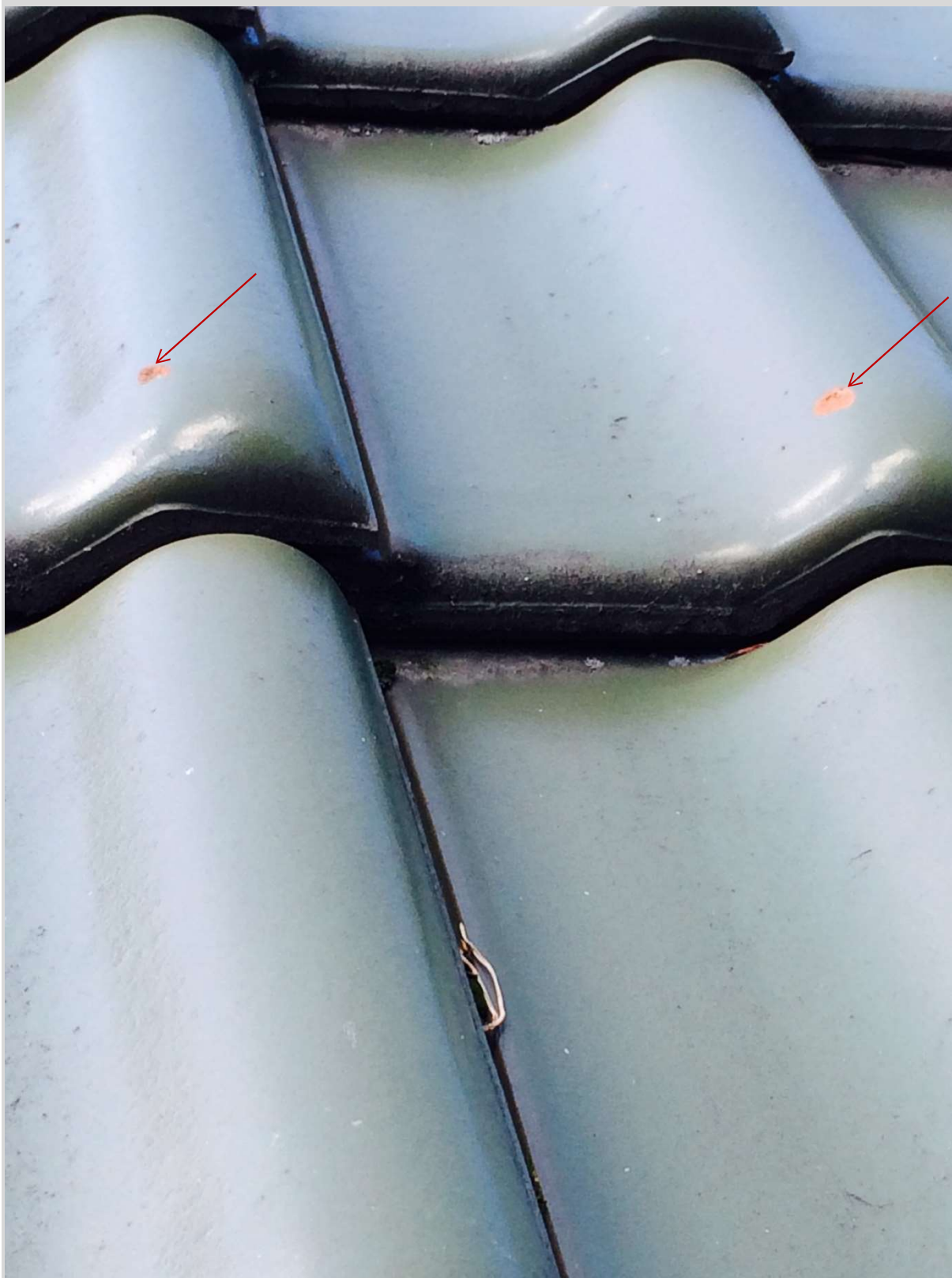
Abbildung 3: Kraterförmige Abplatzungen an verschiedenen Stellen der Dachziegel
