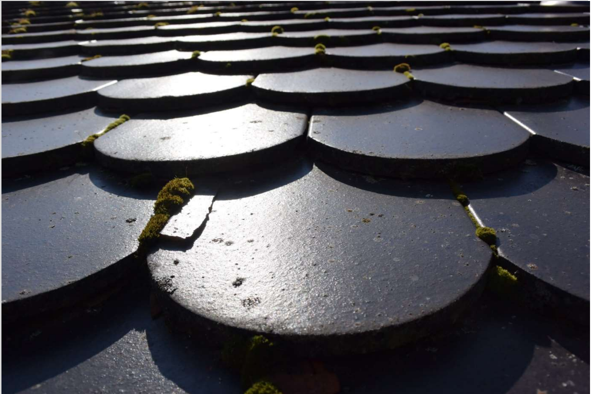
Abbildung 6: Abspregung an engobierten Biberschwanz-Ziegelkanten
