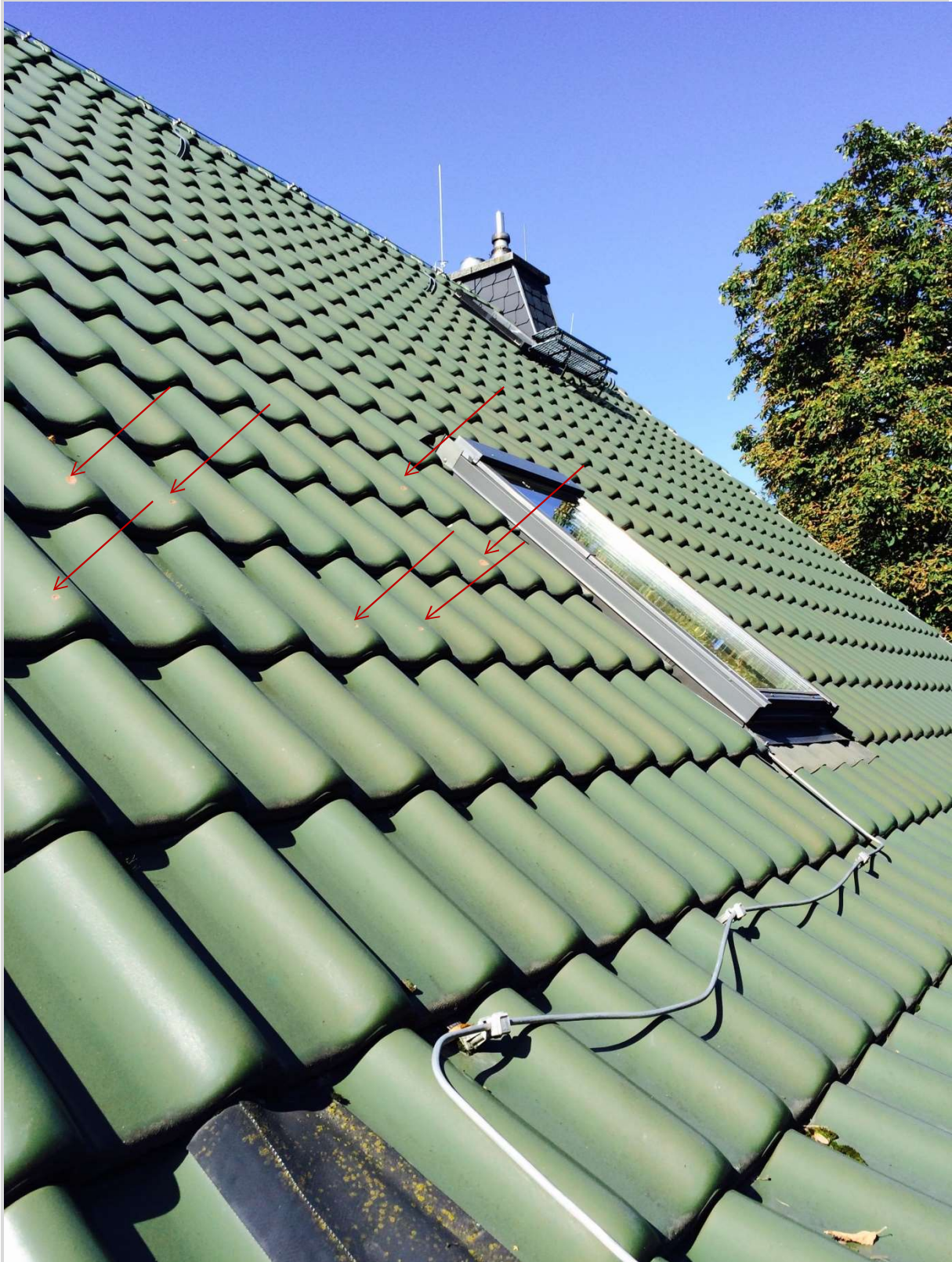
Abbildung 1: Kraterförmige Abplatzungen an verschiedenen Stellen der Dachziegel
