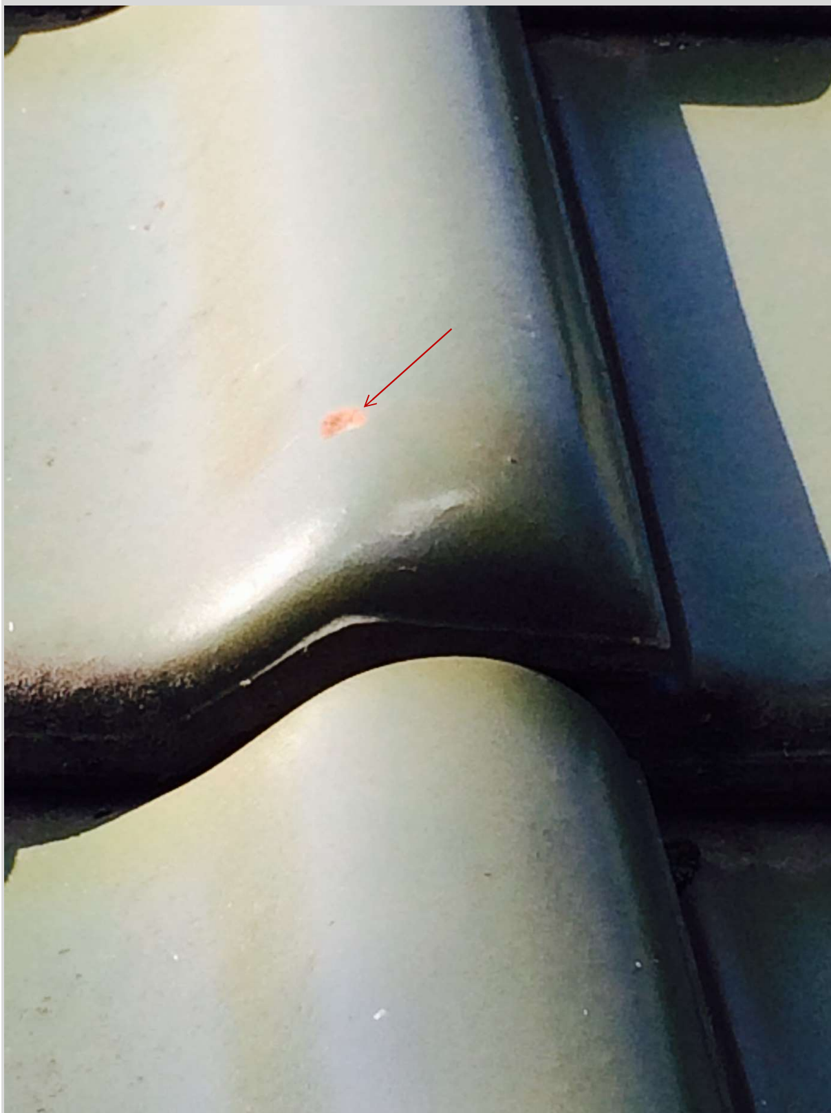
Abbildung 2: Kraterförmige Abplatzungen an verschiedenen Stellen der Dachziegel
