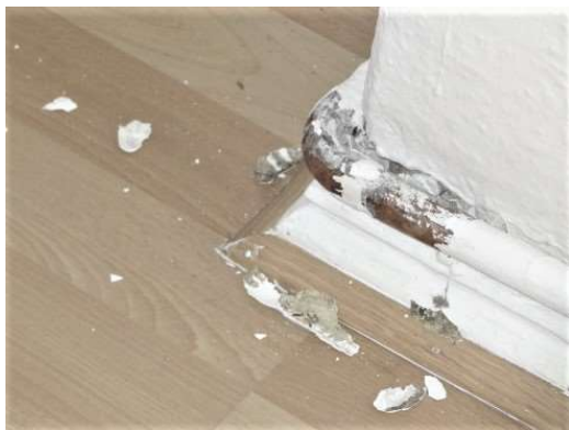
Abb. 2: Undichtigkeit – Verbindungen Kupferrohr
